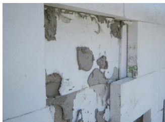
Sanace chybného lepení a vrstvení ETICS
