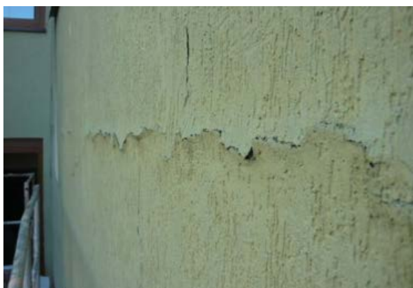
Příčiny vzniku trhlin
