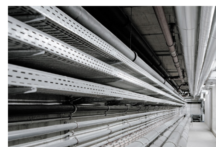
Kabelové žlaby, potrubní instalace
